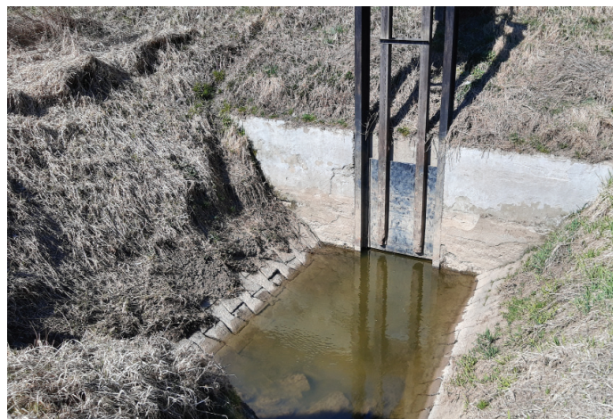
Stara śluza jest w złym stanie technicznym (Fot. UG)
