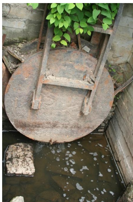
Fot. 5. Wylot z klapą zwrotną Zbiornika Rontok Duży
