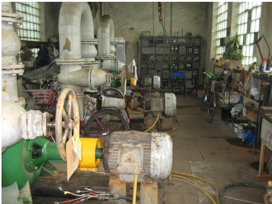
Fot. 2. Zespół pompy w pompowni wód gruntowych
