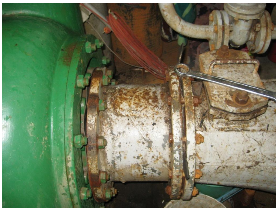
Fot. 3. Rurociąg tłoczny
